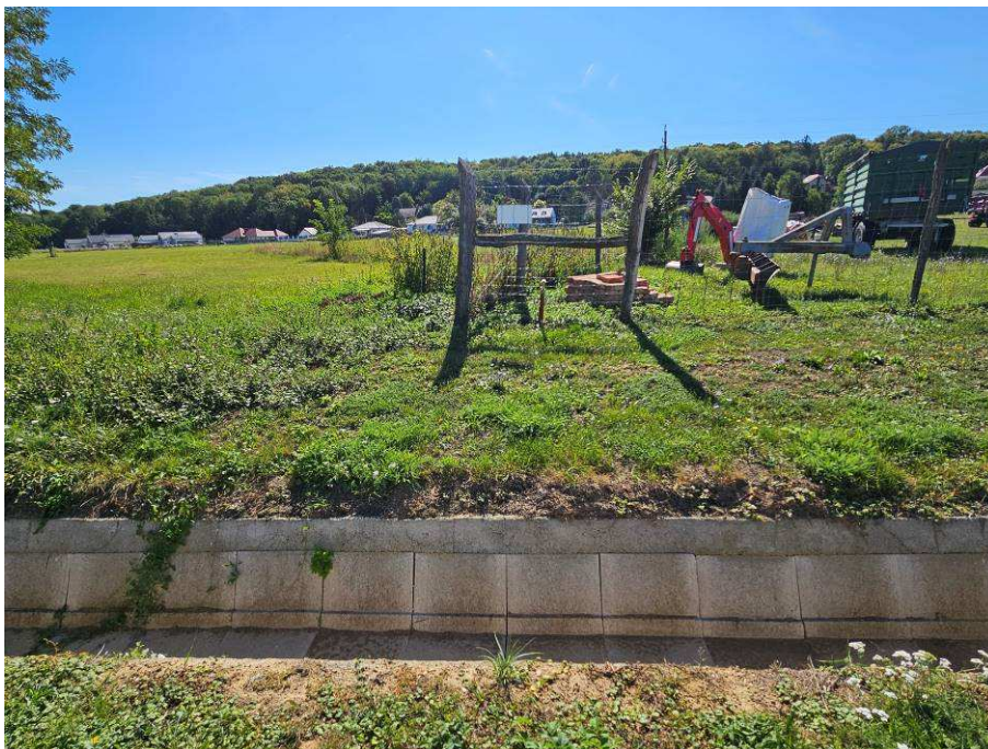
A volt levezető árok (szemben a magasabb fűvel benőtt területsáv) indulásának egykori helye és a mai vízelvezetés kialakítása (beton árok)
