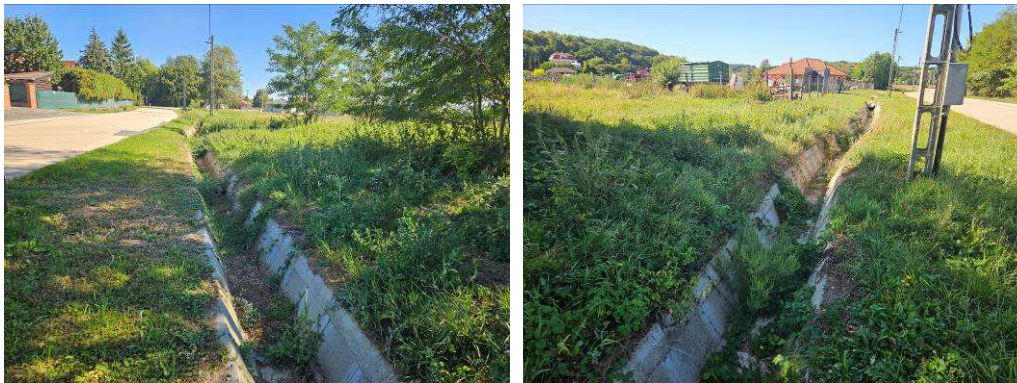
Deák Ferenc utca megújult csapadékvíz-elvezető rendszere
